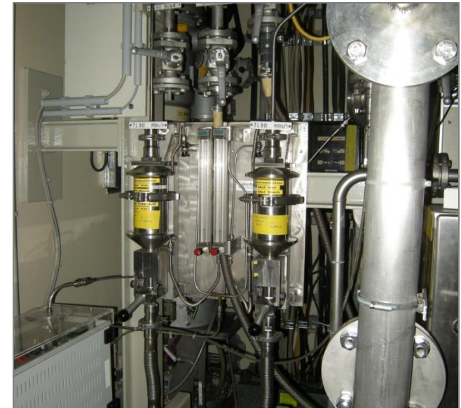
Blick auf die bilanzierenden Filter für die Fortluft im Aktivitätsmessraum
